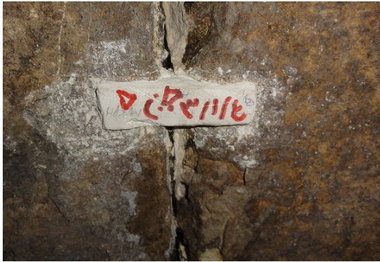
Fig.4 赤ピラミッド内部の亀裂に接着された石膏 2011年8月19日
